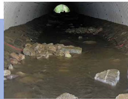
Erfolgreicher Umbau: Steinriegel im Durchlass unter der Panoramastraße direkt nach dem Umbau im Herbst 2015.
