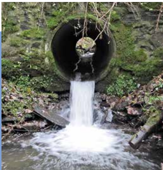
Glatte, schnell durchströmte Rohre stellen ein Hindernis für Fische und Kleinlebewesen im Bach dar.
