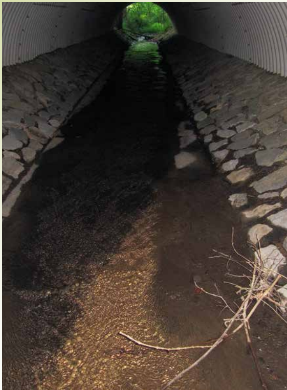
Durchlass unter der Panoramastraße vor dem Umbau im Juni 2014: durch eine 55m lange, glatte Betonsohle für Fische nicht passierbar.
