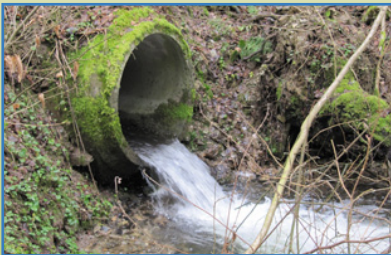
Verrohrungen: Unüberwindbar für Bachorganismen
